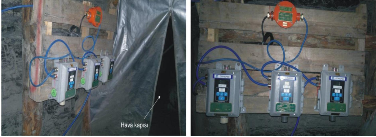
Şekil 1. Hava dönüş galerisi üzerindeki gaz izleme istasyonu
